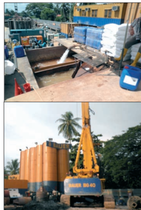
■ [Figura 2].- Vista del tanque de mezcla y silos de almacenaje.
